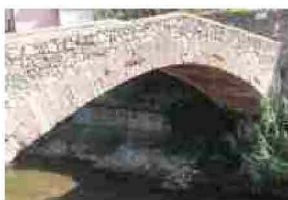
Al via i lavori di sistemazione del ponte Balbi a Riva Trigoso
